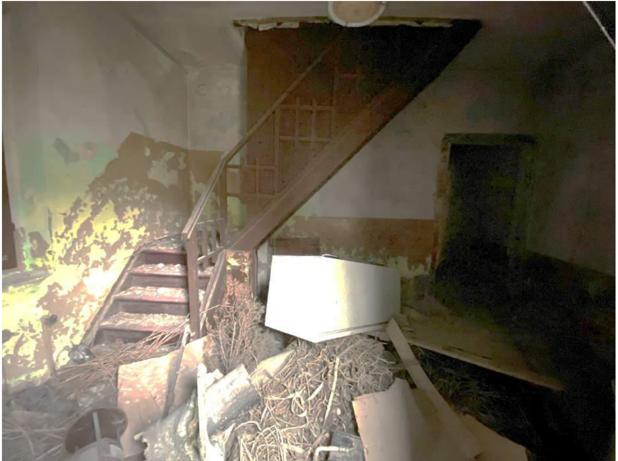
Foto 05 – Vista Interna PT Ingresso
